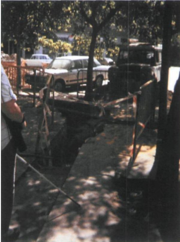
Zanjas por obras sin la protección adecuada
